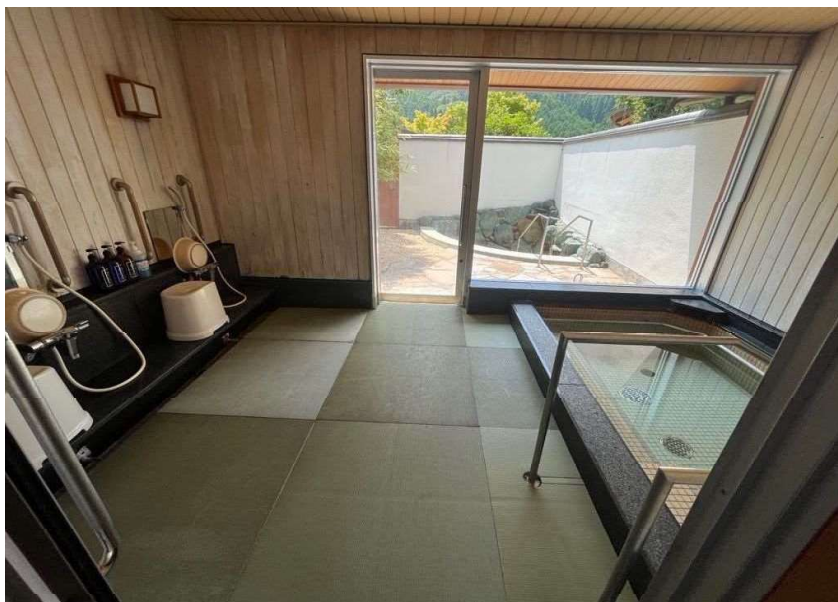
【家族風呂：浴室】 浴室畳の劣化及び汚れ
