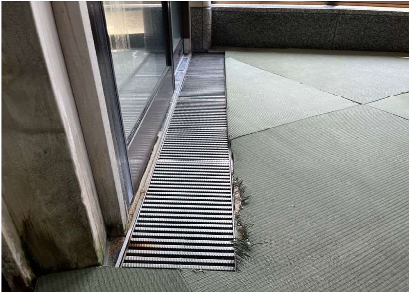
【川の湯：浴室】 浴室畳の劣化及び汚れ
