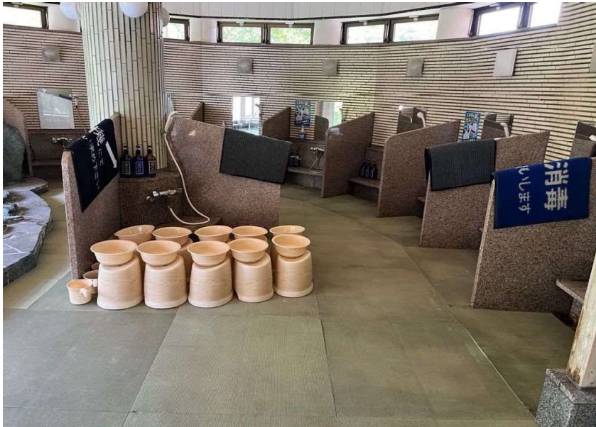
【川の湯：浴室】 浴室畳の劣化及び汚れ
