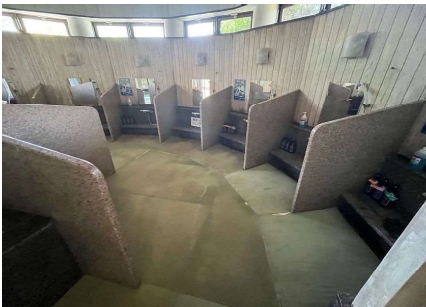
【山の湯：浴室】 浴室畳の劣化及び汚れ
