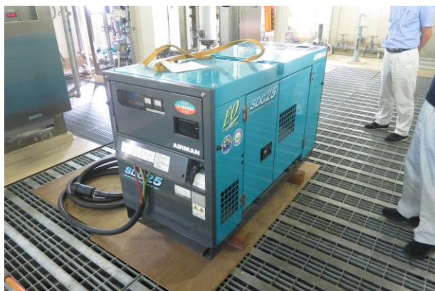
戸原浄水場に設置されている移動式発電機
