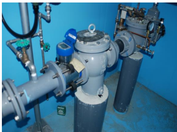
塩田加圧場の流量調整弁（山崎町塩田）
