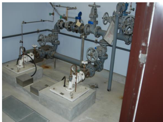
与位加圧場のポンプ設備（山崎町与位）
