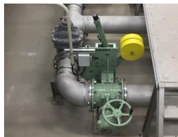
配水池用緊急遮断弁の例
