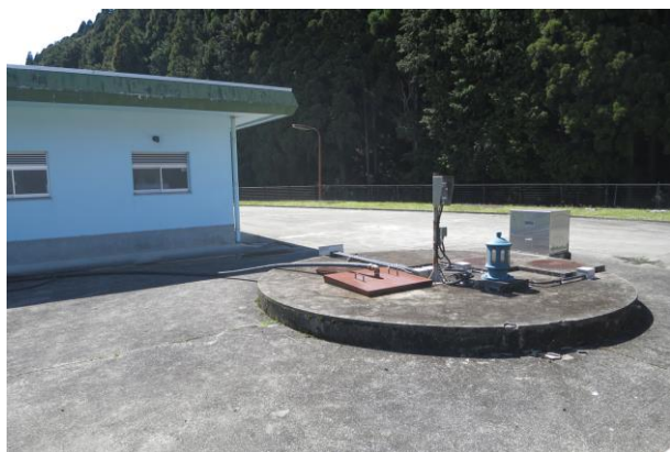
渇水期の取水不良が懸念される西深水源（一宮町西深）
