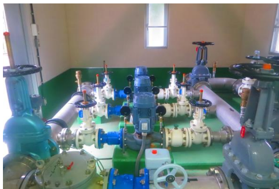
強化した導水ポンプ設備（波賀町原）
