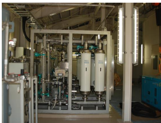
戸原浄水場の膜ろ過設備*（山崎町戸原）
