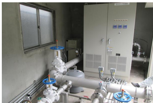
ポンプ設備と制御盤（山崎町須賀沢）
