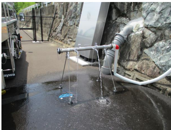
中井接合井に設置した応急給水栓
