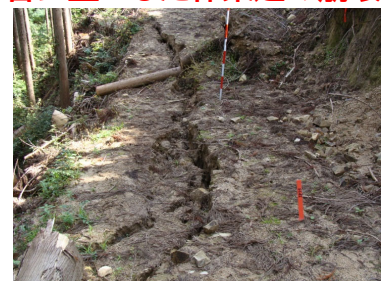
盛土で発生したクラック
