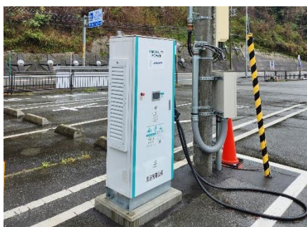
(写真 道の駅みなみ波賀 電気自動車用急速充電器)
