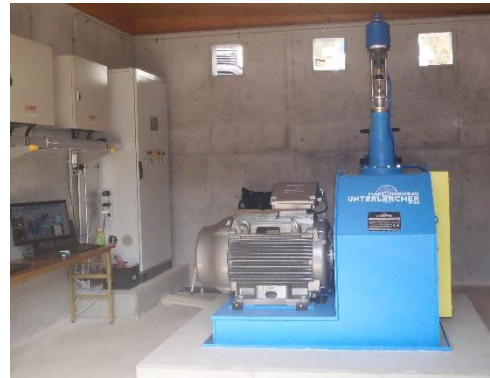
(写真 黒土川小水力発電所)
