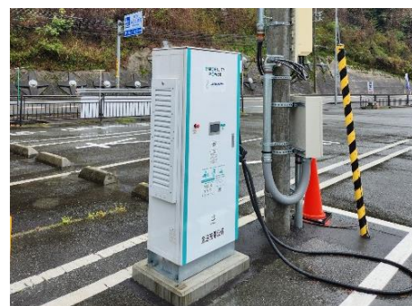
急速充電器（道の駅みなみ波賀）
