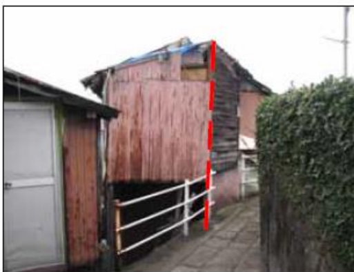
一部の柱が傾斜している例
