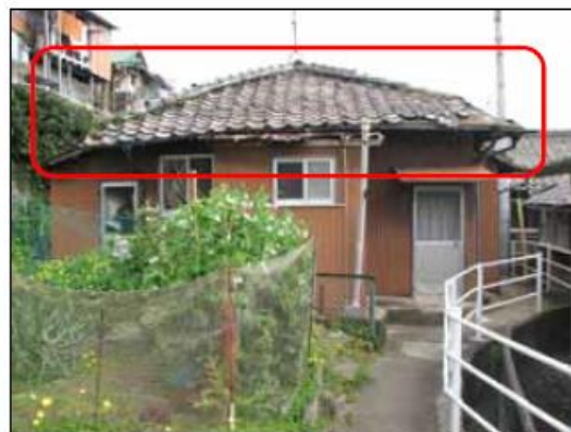
屋根に不陸がある例
