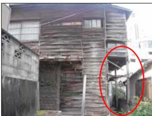
柱の数箇所に破損がある例
