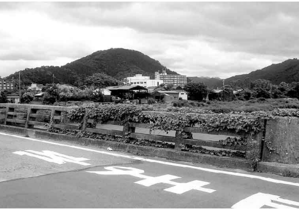
老朽化する穴栗橋
