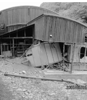
被災した福知渓谷総合センター
