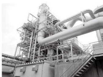
木質バイオマス発電施設
