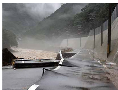
一宮町安積 道路の被害状況 （主要地方道養父実粟線）
