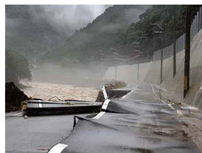
一宮町安積 道路の被害状況 （主要地方道養父穴栗線）
