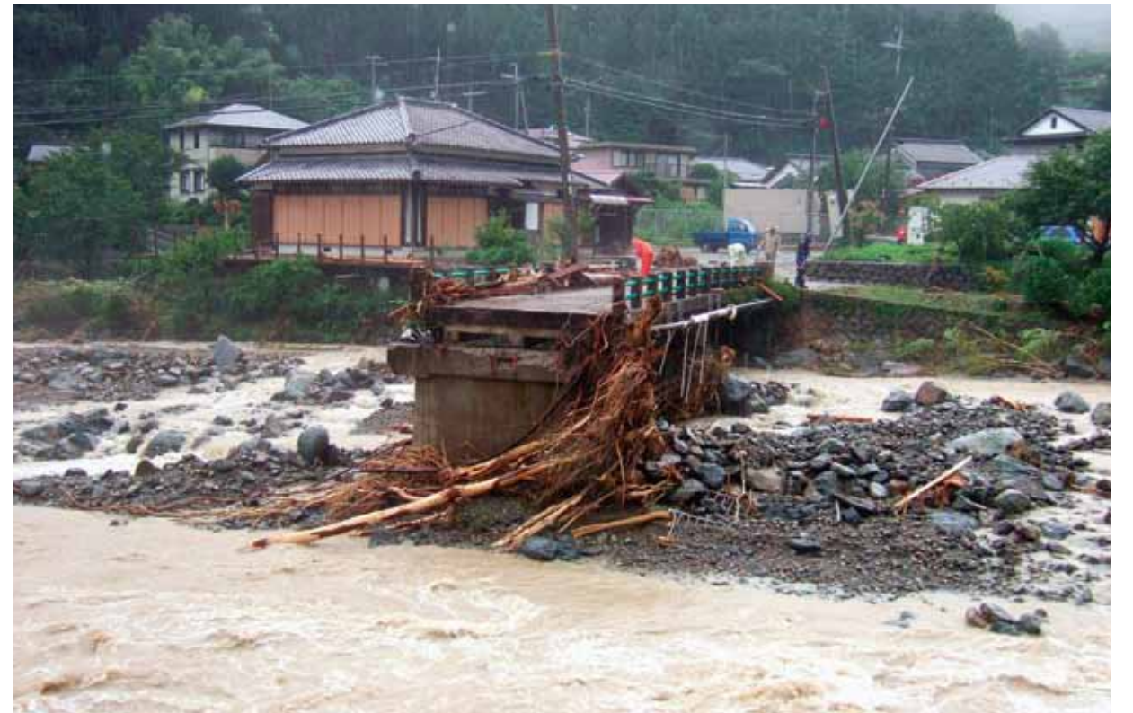
一宮町福知 崩落した津羅橋
