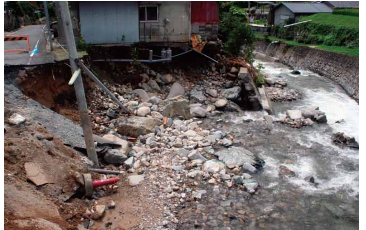
波賀町谷 谷川と市道谷水谷線の崩落
