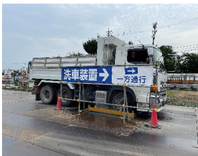
タイヤ洗浄設備（例）
