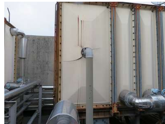
<屋上高架水槽>
